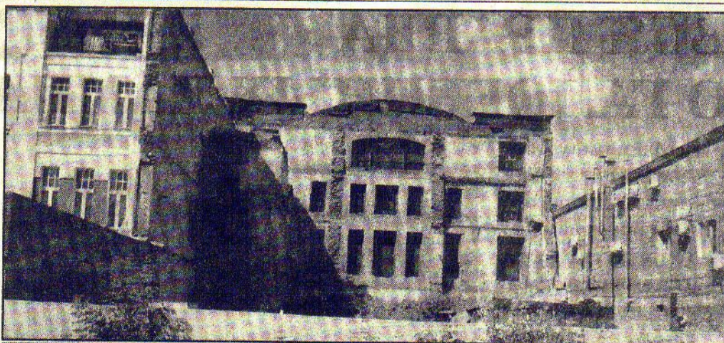
От 4-этажного склада сельскохозяйственной продукции, сгоревшего еще 25 лет назад, на ул. Тарской осталась одна стена
